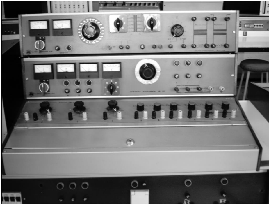
Αυτόνομη μονάδα παροχής AC και DC τάσης με μεταβλητά φορτία .
